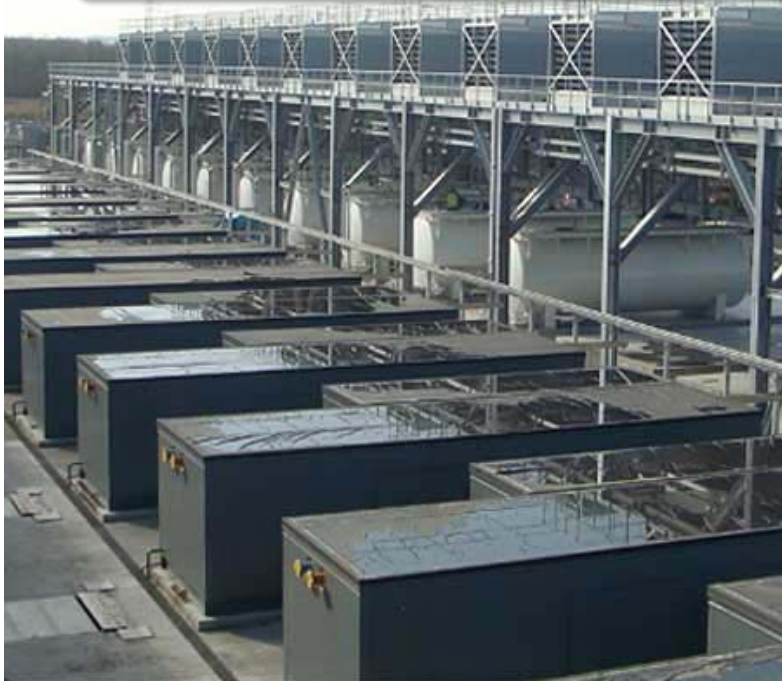
ベルギーにあるGoogleのデータセンター
